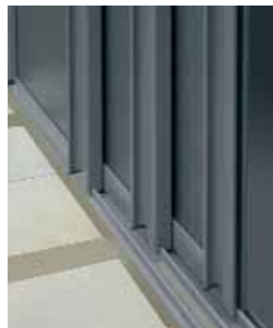
Fußpunktsituation, dreispurige Schiebeanlage
